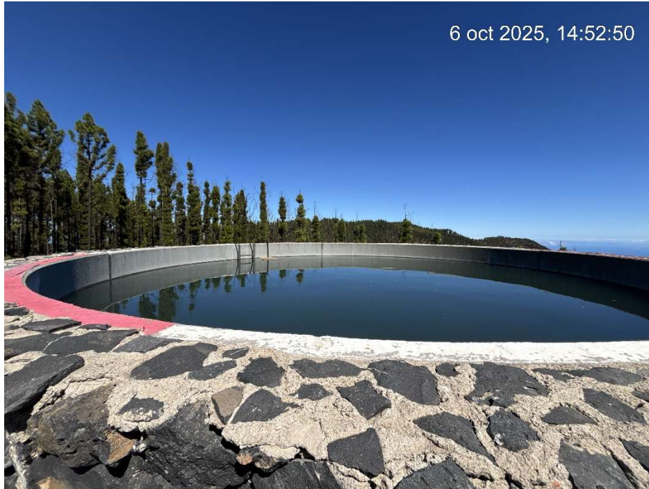
Fig. 2. Vista interior del depósito con impermeabilización y escalera de acceso de acero inoxidable. Foto: REMP / Cabildo de Tenerife, octubre 2025
