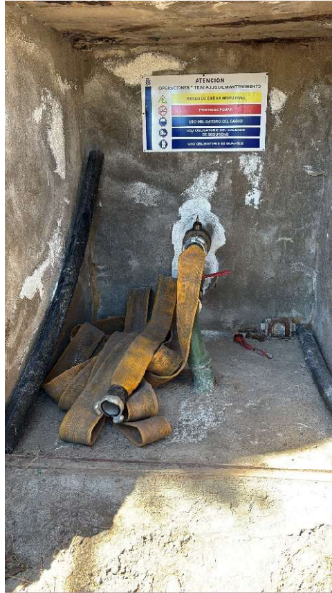
Fig. 5. Punto de conexión para medios de extinción con racor tipo Barcelona y reductor de presión. Foto: REMP / Cabildo de Tenerife, octubre 2025
